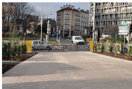
UNE ALLÉE FAITE EN URGENCE À QUELQUES MOIS DES ÉLECTIONS ET MENANT... À UNE BARRIÈRE.
